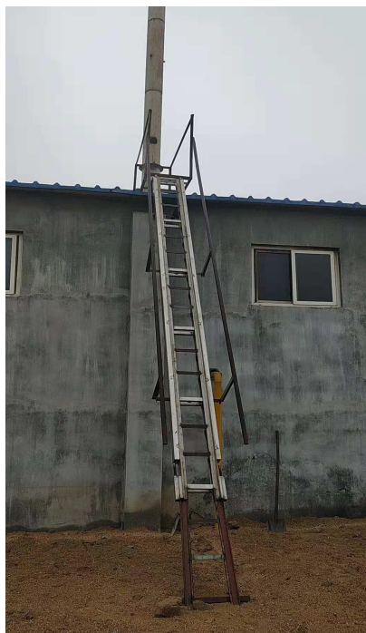
图 3-7 锅炉采样平台
