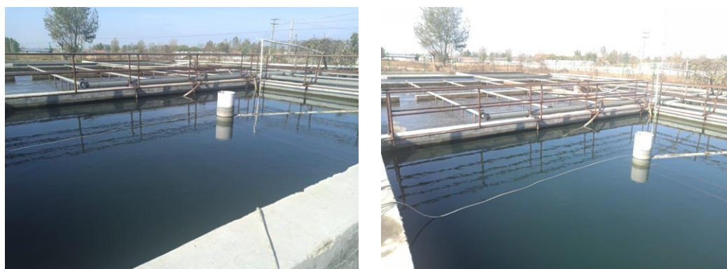
图 3-2 污水处理设施
