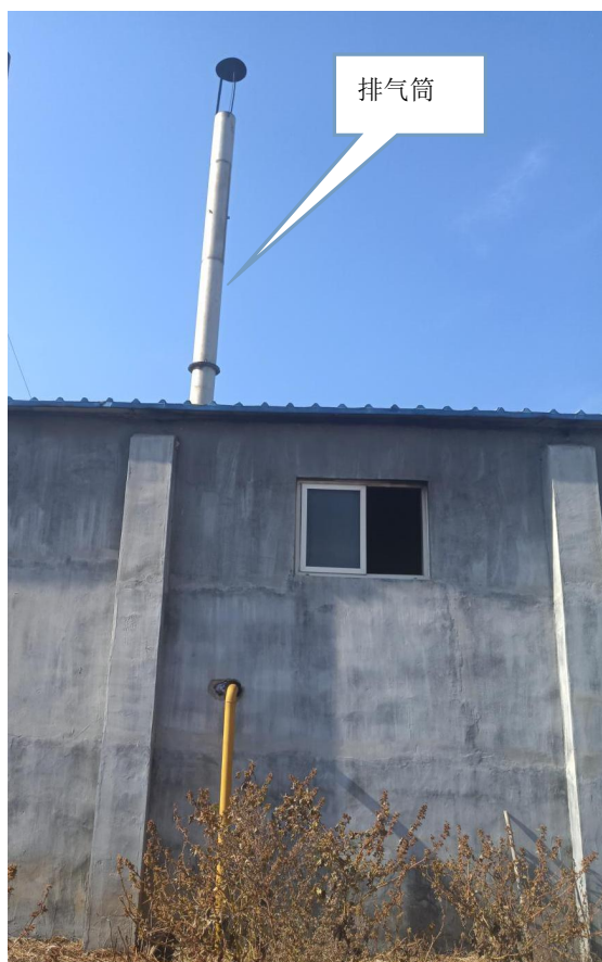
图 3-3 天然气锅炉房
